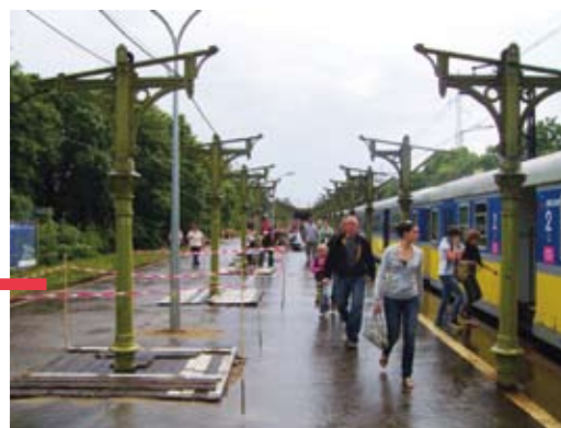
Tak wygląda na wpół zdemontowane zadaszenie peronu
